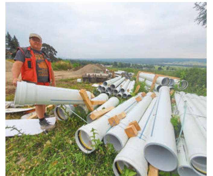
Die neuen Grundstücks-Anlieger haben die Erschließung des großen Baugeländes selbst übernommen. Bald kann gebaut werden.
