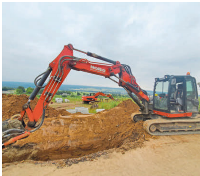
Bagger der Firma Nolte haben begonnen, Erdgräben zur Verlegung von neuen Kanälen auszuheben.
