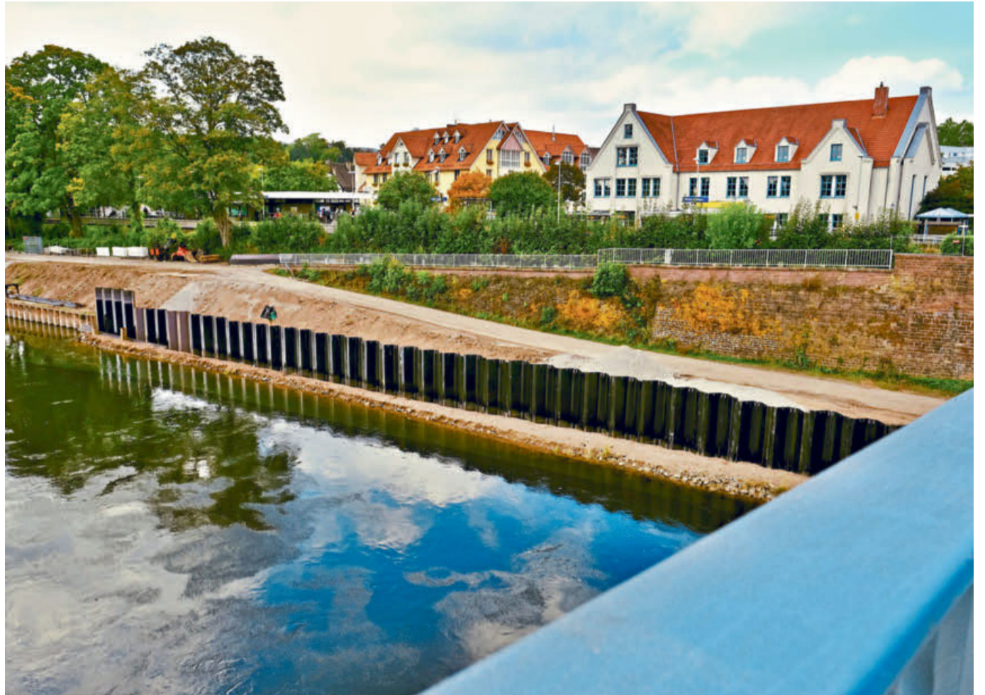
Die Elemente der Spundwand sind etwa acht Meter lang und werden zu etwa zwei Dritteln ins Erdreich gerammt.
