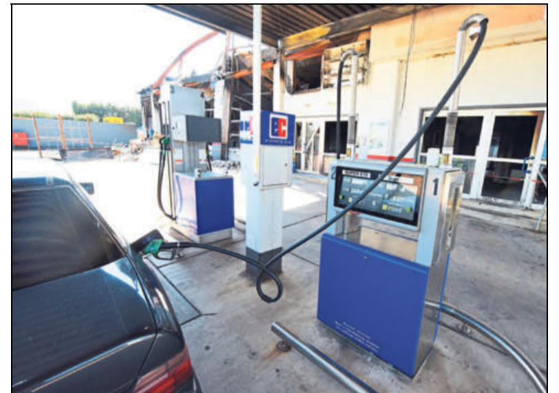
An der Tankstelle im Industriegebiet »Zum Bollkasten« in Bredenborn kann nach dem Feuer wieder getankt werden. Foto: H. Iding
