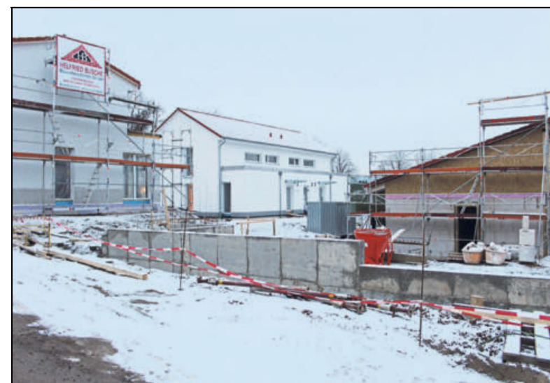
Derzeit wird am Mikroquartier im Lupinenweg in Holzminden noch gebaut. Fotos: Simone Stickel
